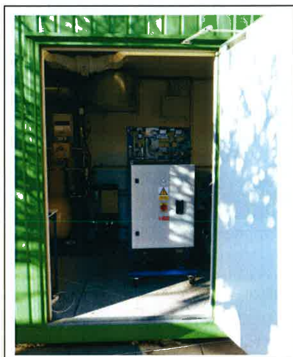
Obr. 8 Pohled do kontejneru na technologii pro dosažení extrémně nízké koncentrace radonu
