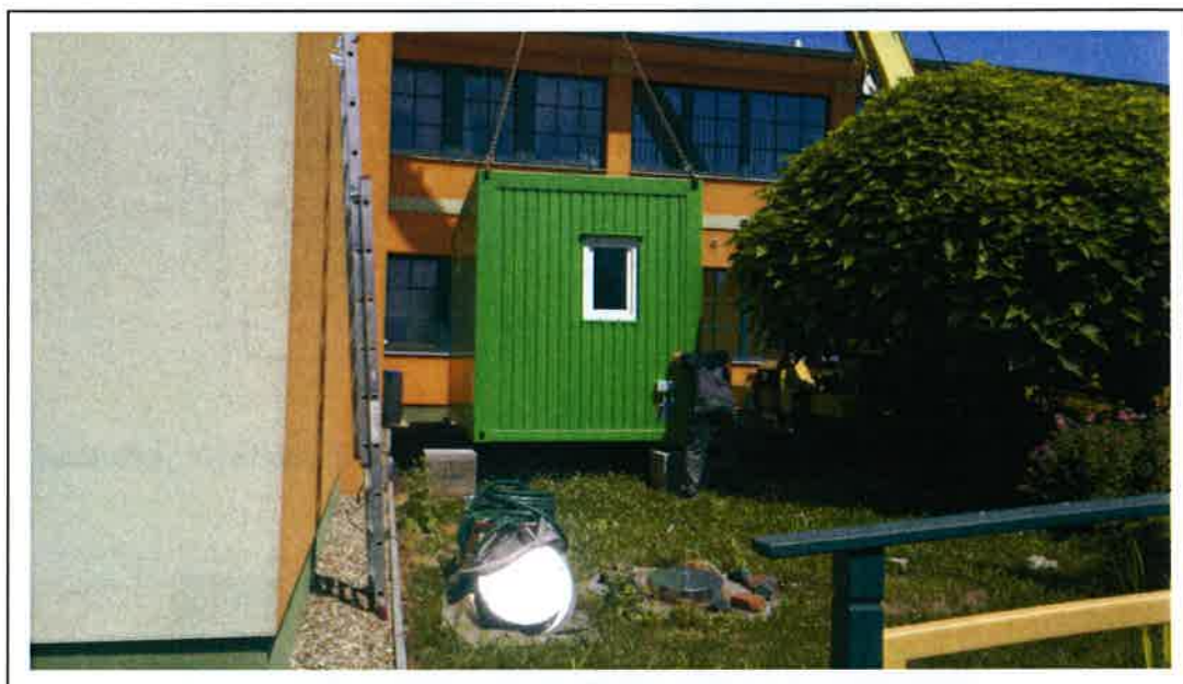
Obr. 7 Pohled na umístění kontejneru
