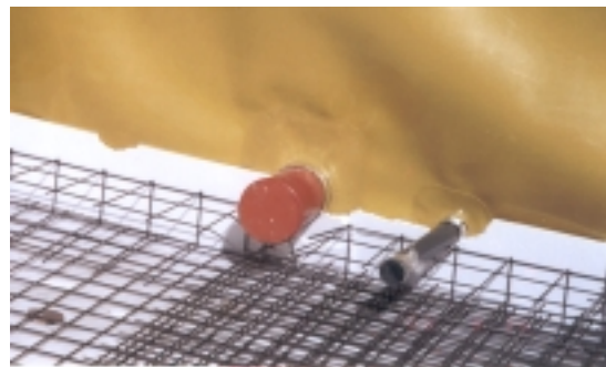
Obr. 24. Horizontální izolace chráněna polystyrénovými deskami před poškozením při betonáži základové desky. V tuto chvíli měla být již chráněna i svislá izolace.
