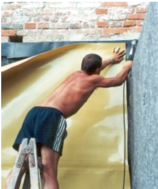
Obr. 23. Předem v horizontální poloze svařené pásy LDPE fólie (Penefol 750) na celou výšku suterénní stěny, se do vertikální polohy fixují horkovzdušným svarem při horním okraji k polyetylenové izolaci dodatečně vložené do řezové spáry pod stávajícím zdívem.
